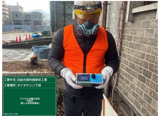
煙突上部 ダイオキシン除去
