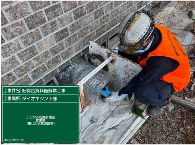
煙突上部 ダイオキシン除去
